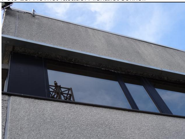
Foto 14: Rusten facadearmering m. afskalninger.
