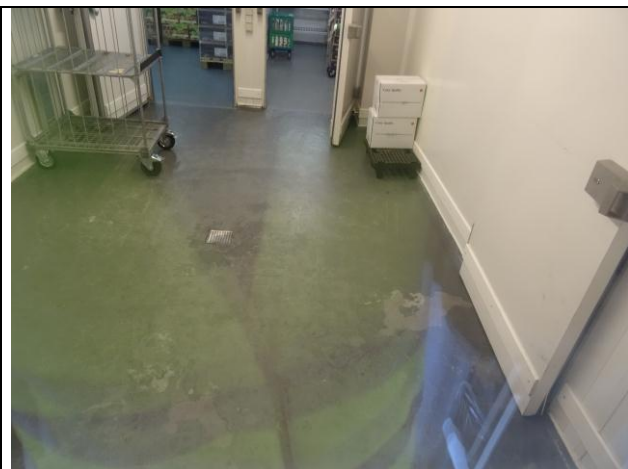
Foto 25: Afskallet epoxygulv ved kølerum
