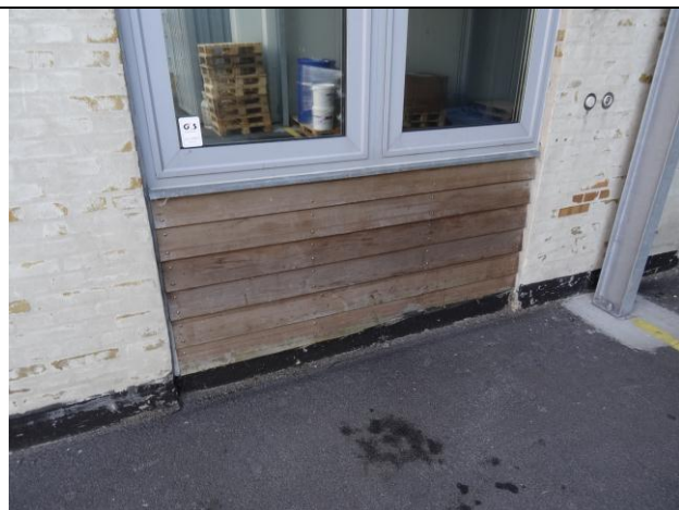
Foto 19: Defekt træbeklædning, mgl. vedligehold.
