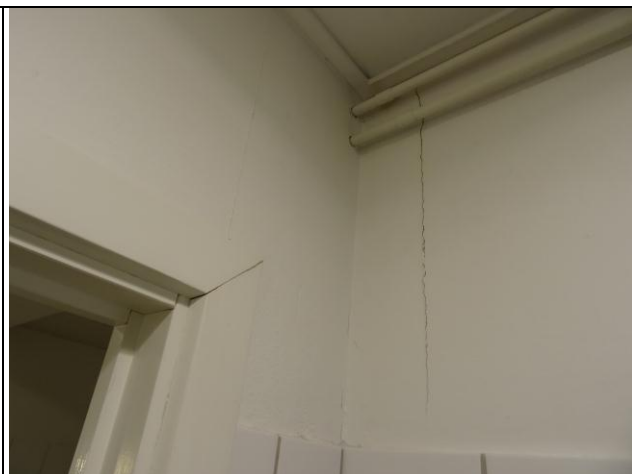
Foto 28: Revner i gulv & vægge. Velfærdsrum.
