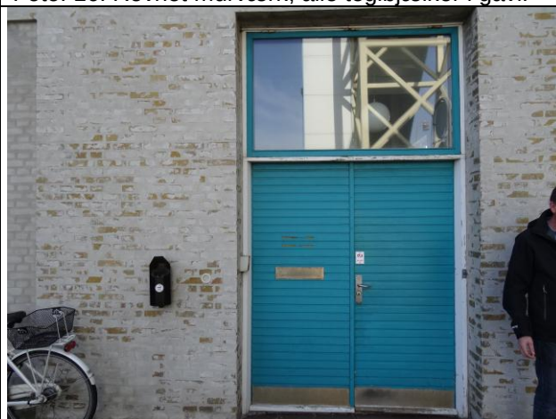
Foto 17: Forvitret tyndpuds. Nedbrudt trædør.
