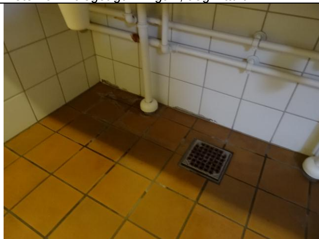
Foto 27: Tæret rør, revnede fliser & klinker.
