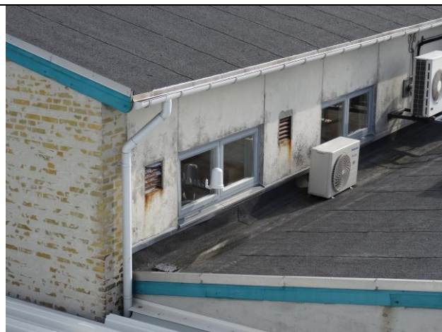
Foto 10: Begroet facade, rustne riste
