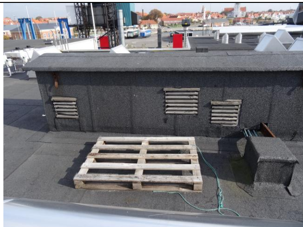
Foto 4: Ventilatorhus, nedslidt pap
