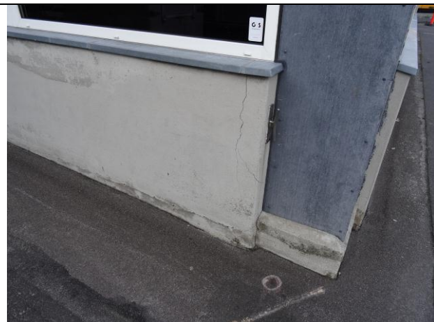
Foto 13: Revnet facade. Afskallet sokkel.
