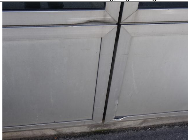
Foto 20: Skadet alu-parti, paskontor.
