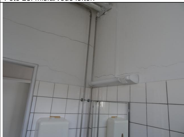
Foto 24: Vådrum med revnede vægge.
