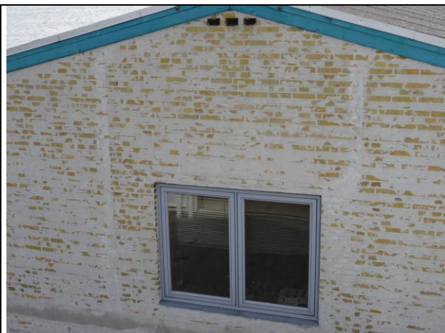
Foto 7: Revne i gavl og tegloverligger.
