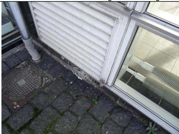
Foto 15: Nedbrydning i karme, vindfang.
