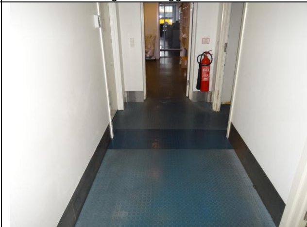
Foto 29: Hævet terrændæk. Gang v. printerrum.
