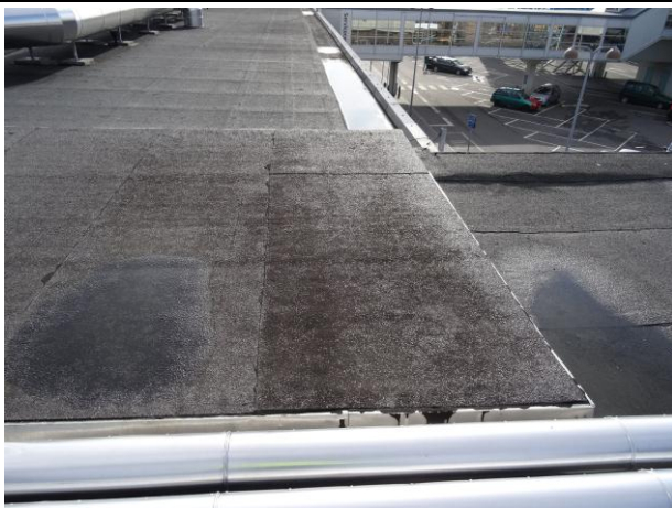
Foto 3: Opbygget tag er nedslidt.
